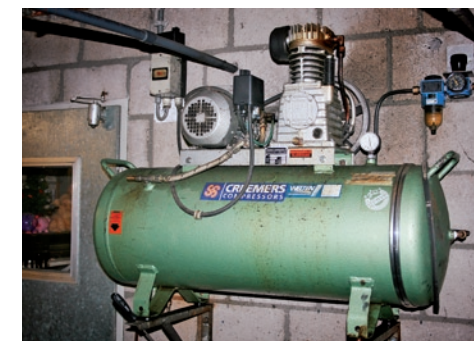
Het systeem werkt op luchtdruk. De 160 balansroosters worden door één compressor op de centrale gang aangestuurd.
